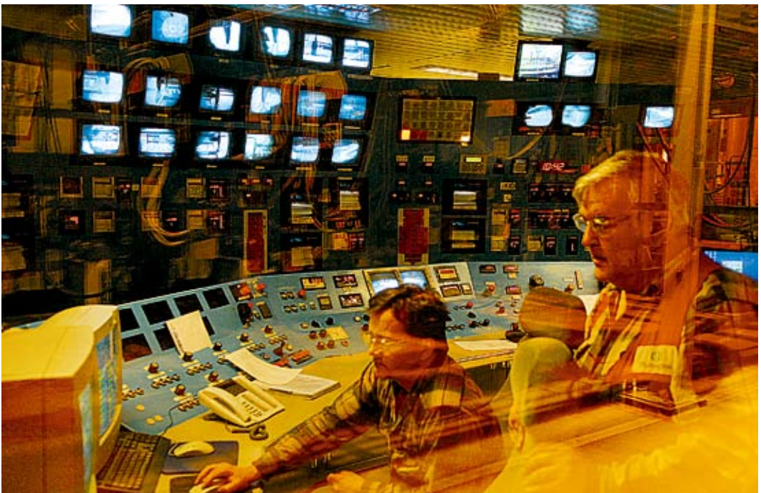
Lasitehtaan valmistusprosessi on automatisoitu ja valvontatyötä tehdään tuotantotiloista hyvin eristetyssä valvomossa.
